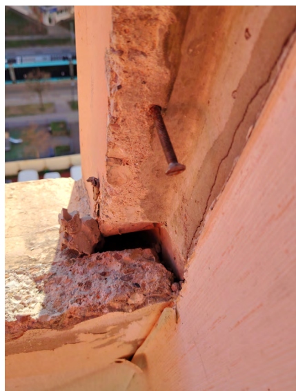
Disjointement entre le bas de l'ancienne fenêtre et la fente du pilier situé dessous © Natura SCOP
