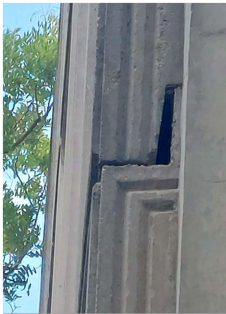
Disjointement en forme de L © Natura SCOP
