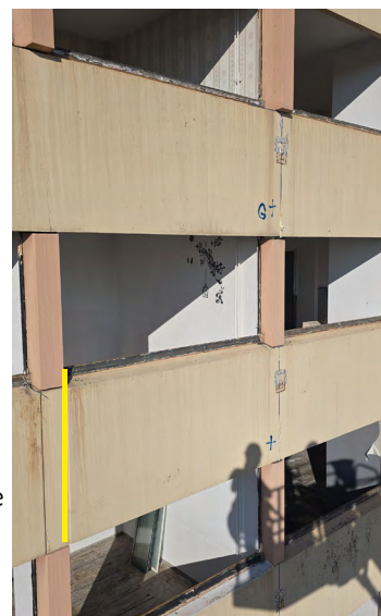
Disjointement entre le bas de l'ancienne fenêtre et la fente du pilier situé dessous © Natura SCOP
