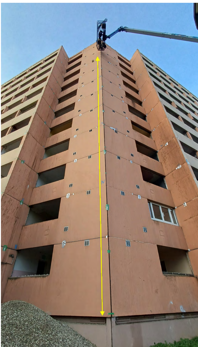
Disjointement entre deux blocs de bâtiment © Natura SCOP
